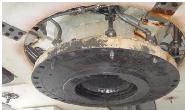
Mitad superior del conector del LMRP que falló.
