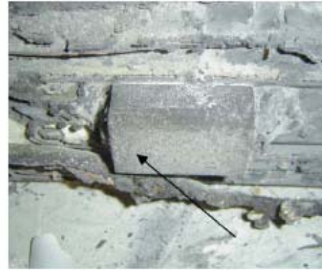
Bobina autorreguladora recalentada (causa principal del incendio).
