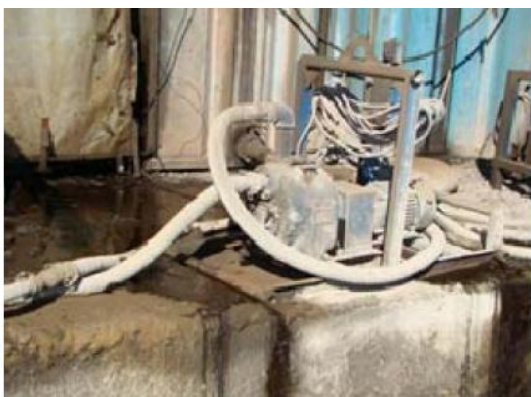
Figura 4: Inspección de verificación luego de dos meses para la misma bomba de transferencia que inició el alerta de seguridad (ver fotografía siguiente).
