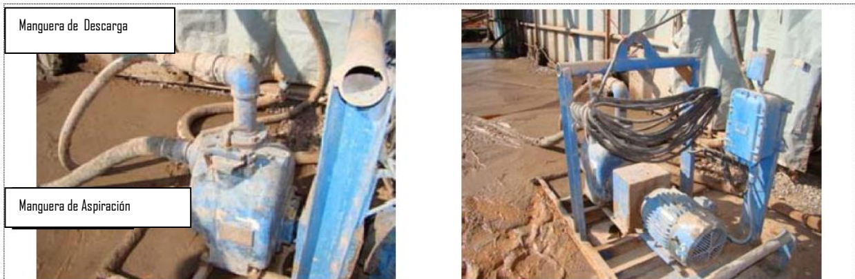
Figura 1: Bomba de transferencia en la fosa de reserva detrás de los tanques de lodo.
