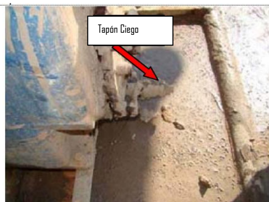
Figura 3: Válvula de alivio en la bomba de transferencia con tapón ciego instalado (no se puede aliviar la presión de la válvula).
